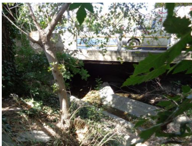
Εικόνα 48: Συγκέντρωση υδάτων στο τμήμα της οδού Ανθέων.
