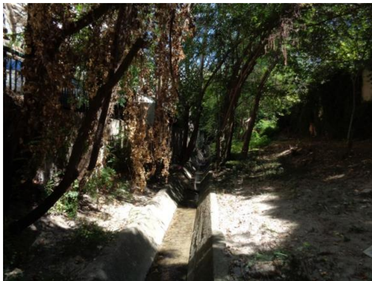
Εικόνα 47: Άποψη της κοίτης και της αδιαμόρφωτης όχθης του ρέματος Ν. Τυπά.
