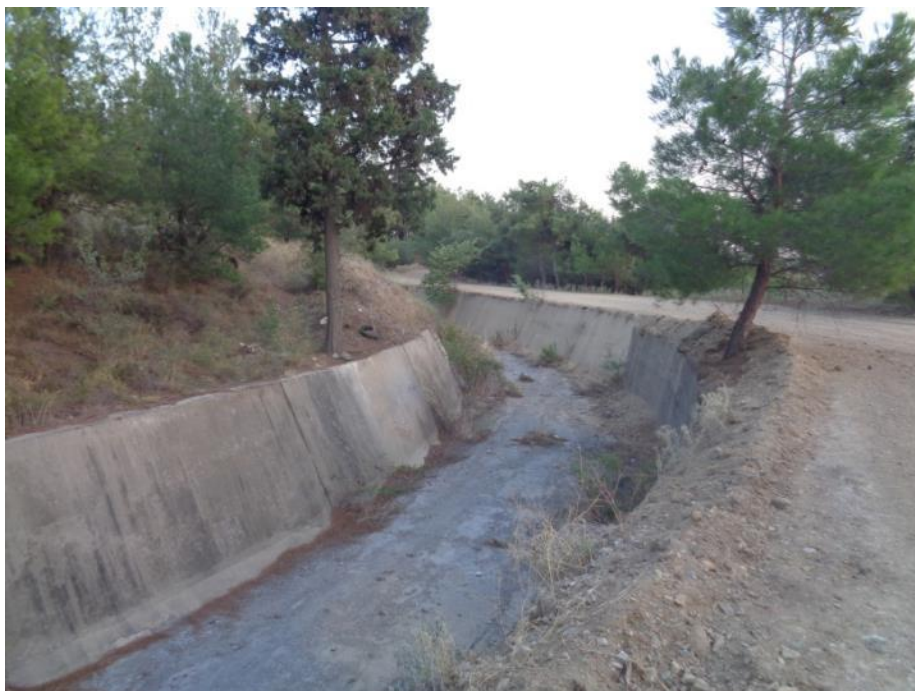
Εικόνα 49: Η πορεία της Τάφρου μετά την είσοδο της στο Π.Σ.Θ.
